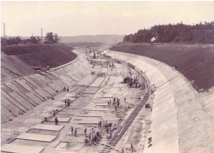
Das Innkraftwerk Töging mit der fast 23 Kilometer langen Kanalanlage war die größte Baustelle Mitteleuropas.
