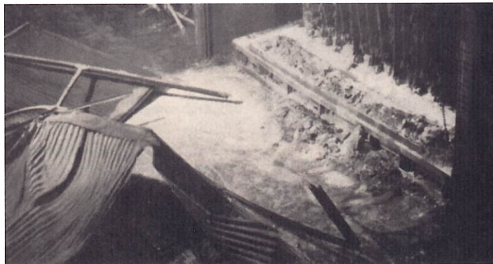
Beschädigter Ofen im Ofenhaus II
